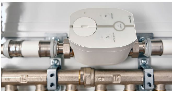
LK CubicSecure installert i et fordelerskap.
